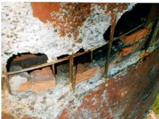
Рис. 1. Сквозные отверстия в стене дымовой трубы
